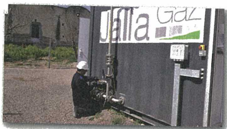
Valorisation du biogaz en cogénération
