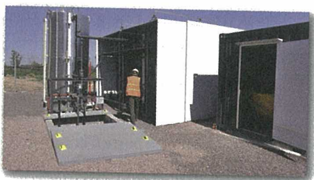
Jallagaz : unité de micro-méthanisation
